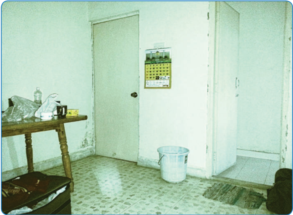
غرف الإقامة في المستشفى قديمة وغير نظيفة
